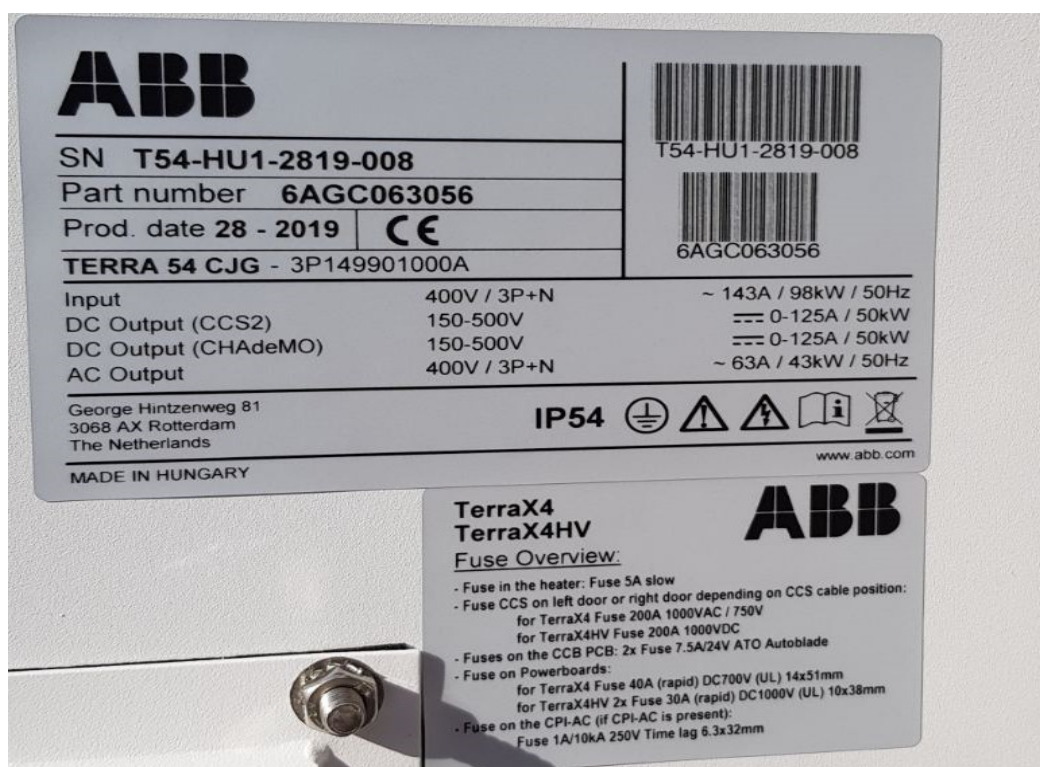
Slika 6: Specifikacije nove punionice postavljene na lokaciji – Autobusni kolodvor Poreč
